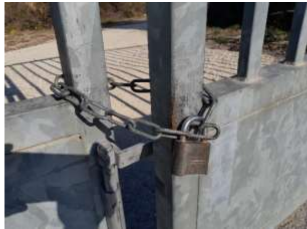
Cadenas nouveau portail d'accès (cadenas facilement destructible)
